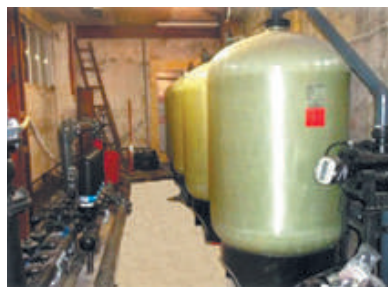
Станция обезжелезивания хозяйственно-питьевого назначения производительностью 2800 м 3 /сутки
