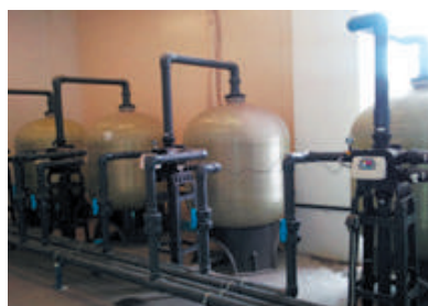
Станция обезжелезивания хозяйственно-питьевого назначения производительностью 2200 м 3 /сутки
