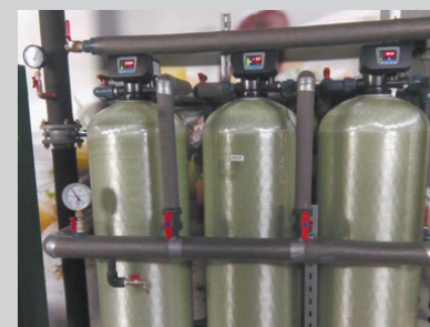
Комплексная станция водоподготовки производительностью 5 м 3 /ч для пищевого производства (обезжелезивание, удаление нерастворенных примесей, тонкая очистка, УФ-обеззараживание)
