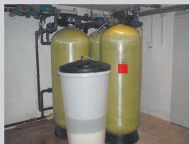
Станция обезжелезивания производительностью 10 м 3 /ч для элитного многоквартирного дома
