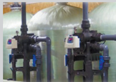
Станция обезжелезивания и деманганции воды хозяйственно-питьевого назначения производительностью 1000 м 3 /сутки
