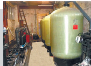
Станция обезжелезивания хозяйственно-питьевого назначения производительностью 2800 м 3 /сутки
