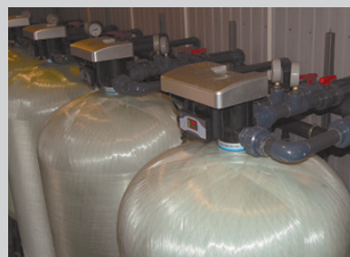
Станция обезжелезивания и обеззараживания воды производительностью 800 м 3 /сутки для детского оздоровительного лагеря
