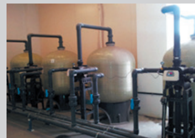
Станция обезжелезивания хозяйственно-питьевого назначения производительностью 2200 м 3 /сутки
